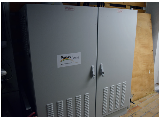
Energieoptimierungsmaschine (Anlage zur Verbrauchssenkung durch Spannungsreduzierung)
